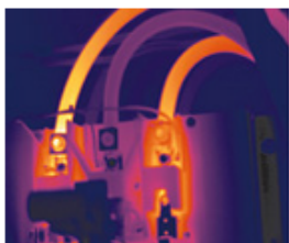
Mala conexión y daños internos
