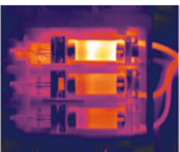
Daños en fusibles internos
