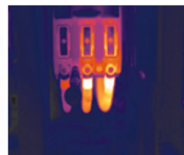
Corrosión en conexiones
